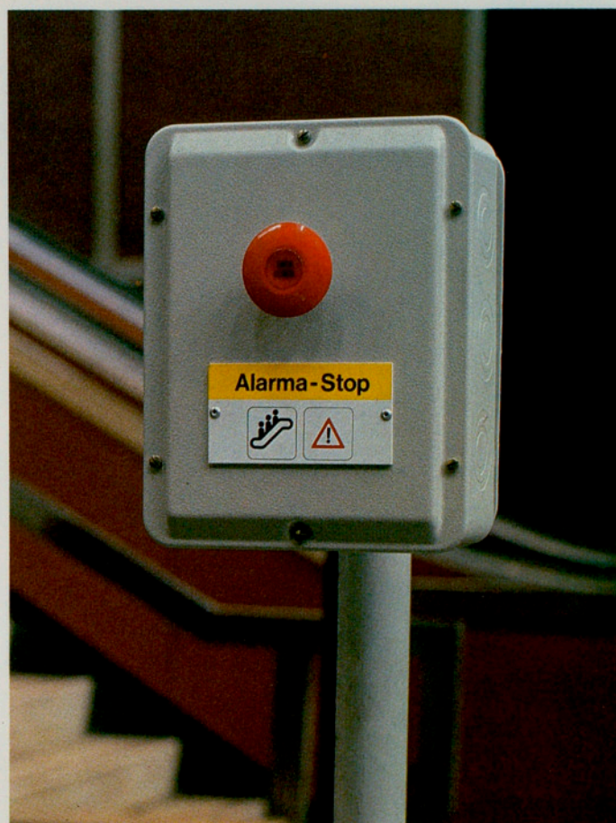
Aparell d'alarma de les escales mecàniques F.G.C.
