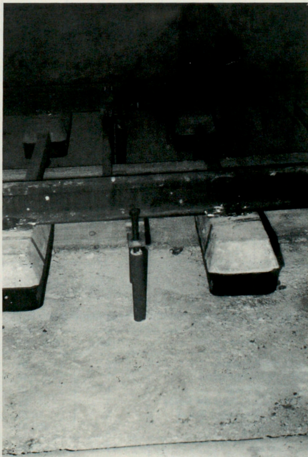
Detall de la superestructura del tram «Torrassa» - «Av. Carrilet» de la L1 del FMB. (Barcelonès).
