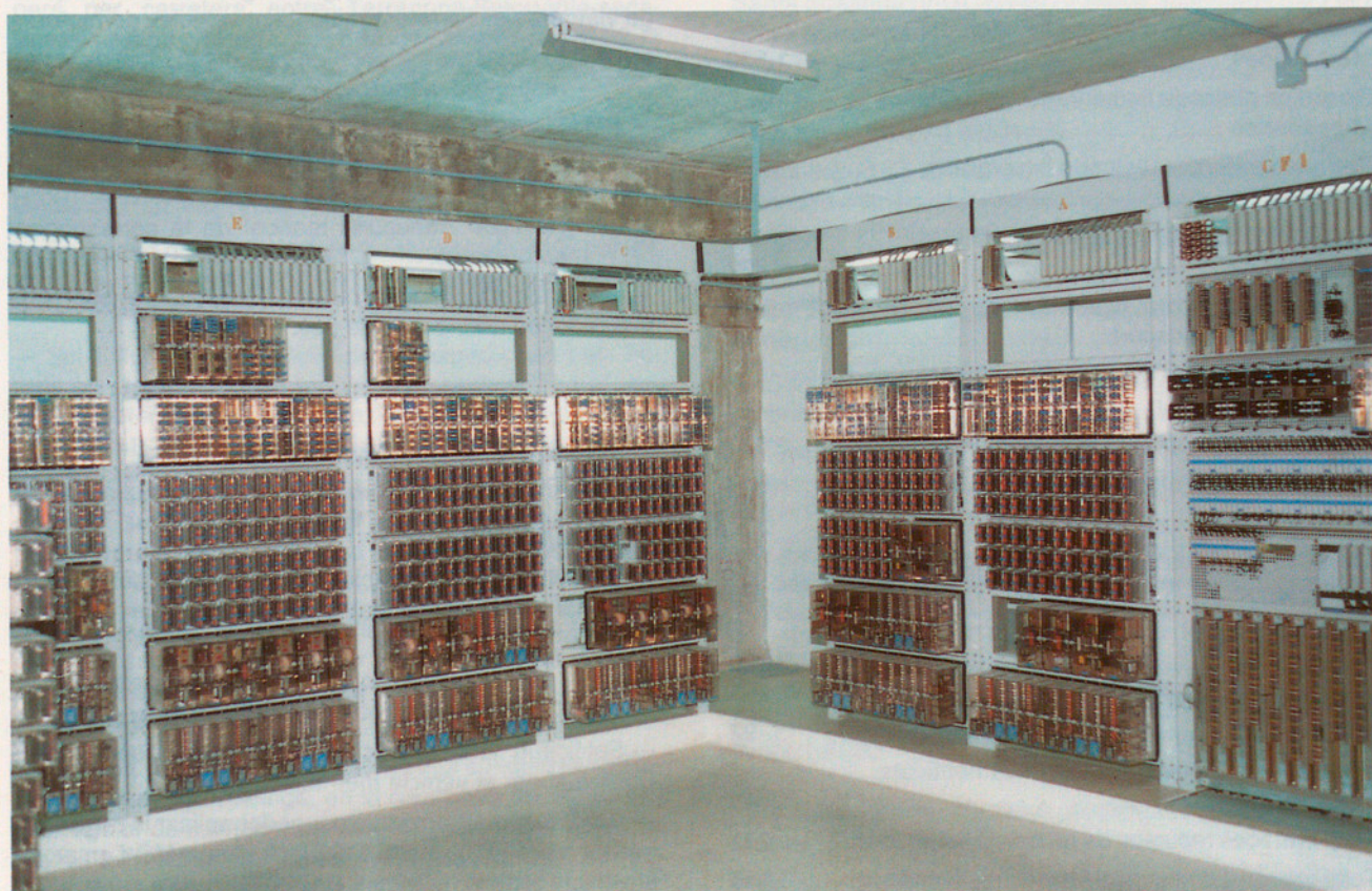
Equipaments elèctrics de les cotxeres i tallers de St. Genís de la L3 del Metro de Barcelona (Barcelonès).
