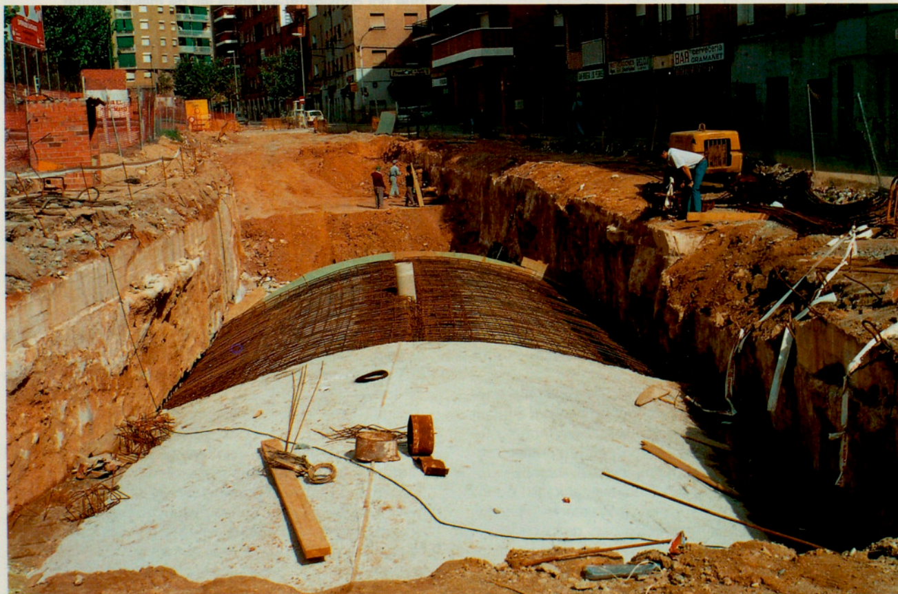
Infraestructura de la cua de maniobres de l'estació de Fondo de l'L1 de l'FMB. (Barcelonès).
